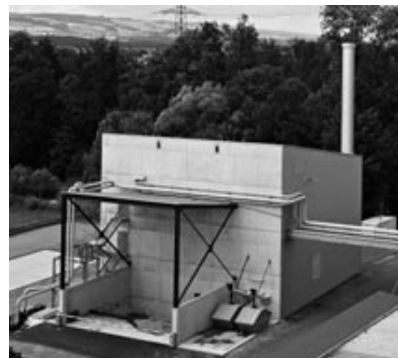
Mit dem neuen Biomassekessel am Standort Cham hat sich bei PAVATEX der Anteil erneuerbarer Energien auf fast 50 Prozent erhöht.
