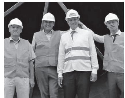
Mitglieder des Verwaltungsrats auf der Baustelle: Dr. Peter Rutishauser, Dr. Christian C. Wenger, Martin Brettenthaler und Laurent Vermer (v. links).
